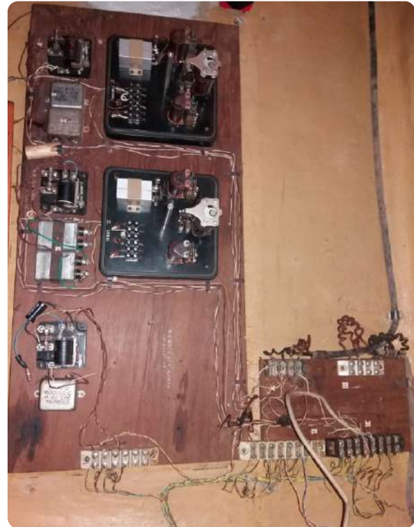
Gambar 8: Perangkat relay yang mentransmisikan sinyal ketukan pendulum dari ruang bawah tanah menuju gedung teleskop
